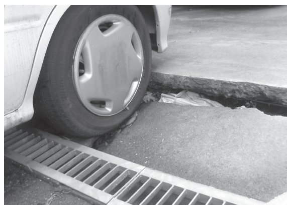
土間コンクリートの沈下対策
