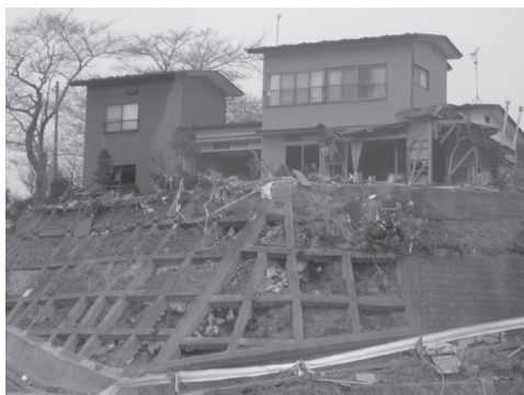
▲ 1階部分が津波の被害を受けている
