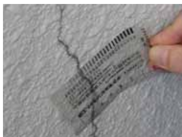
壁のクラック調査
