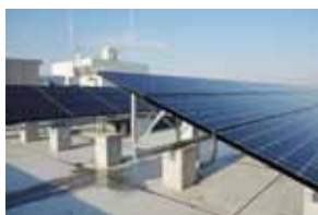
屋上：太陽光発電パネル
