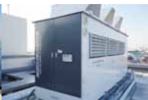
屋上：調湿換気システム
