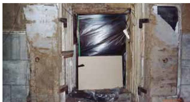
桔梗屋文庫蔵扉修理前
