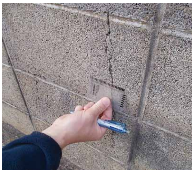
ブロック塀亀裂調査（ブロック塀調査）
