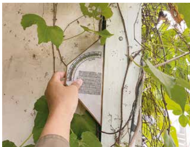
傾斜した建物
